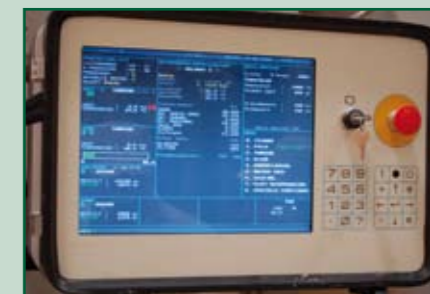
Bedieningspaneel van de installatie.
