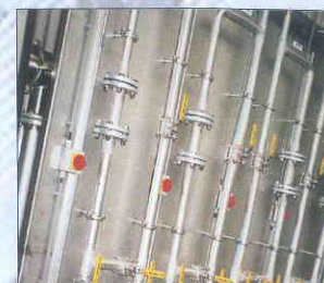
Leidingwerk t.b.v. flocculant-verdeelstation.
