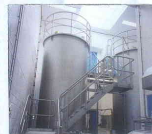
RVS 14 m 3 tanks inclusief trap en bordes.
