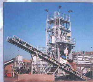
Zandwasoverkappingen en leidingwerk voor slibzuiveringsinstallatie.
