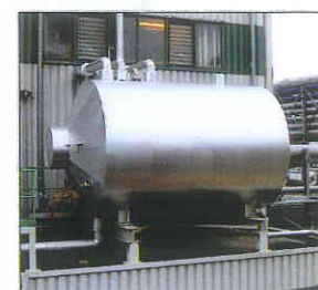
Geïsoleerde 26 m 3 warmwater- tank uit duplex
